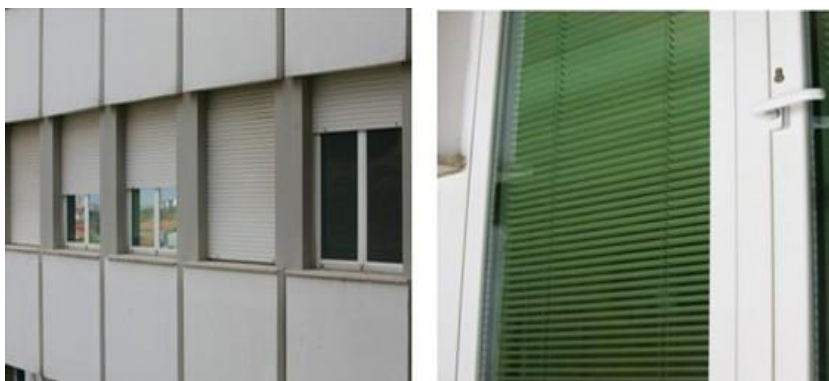
Figura 11: Esempi di schermature su finestre di tipo esterno (tapparelle) e di tipo interno (veneziane)
